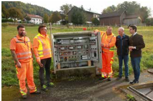
Bürgermeister Martin Pichler (v.r.) und Gemeinderat Horst Jäger freuen sich, dass das Team für geklärtes Wasser mit Georg Braumandl, Jürgen Murr und Christian Hölzlzimmer technisch auf Zack sind und die Anlagen permanent zukunftsfähig halten.
