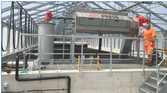
Eine Schneckenpresse am Eingang zur Solartrocknung erhöht die Kapazitäten der Anlage, die an ihre Grenzen gekommen waren.
