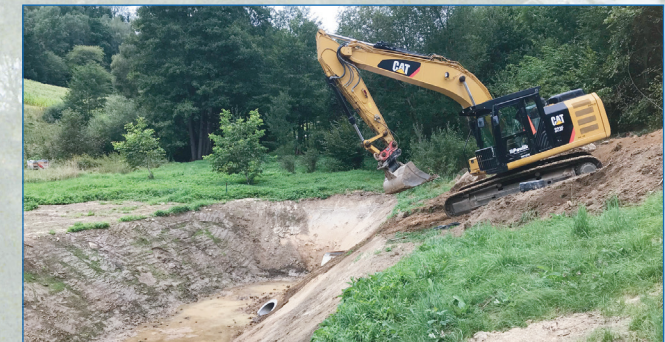
Das Regenrückhaltebecken Burgstall gibt große Regenmengen dosiert an den unterliegenden Bach ab. Das neue Abwassertrennsystem vermindert so zugleich die Mengen, die im Klärwerk ankommen, was teuren Aufwand reduziert.
