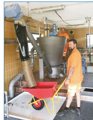
Die neue Sandwaschanlage entnimmt Anteile, die für Wegebau eingesetzt werden können und dann nicht mehr den weiteren Klärprozess belasten.
