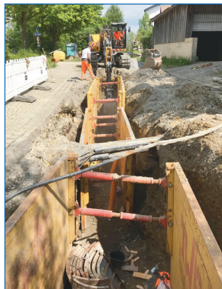
In der Hinteren Gasse des Marktes Schönberg war der alte Kanal defekt und musste komplett ersetzt werden.
